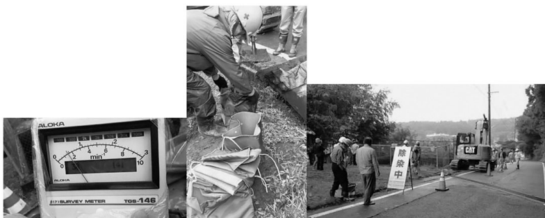
写真 4.4 実証実験の様子 (2015年9月26日、二本松市内の防火水槽にて)
