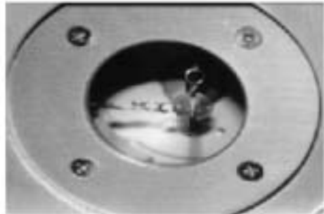
水流噴射部のクローズアップ
